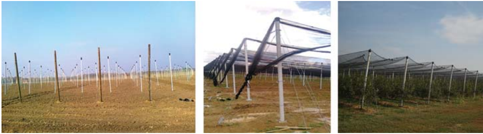
Сл. 24 Анкерски столбови (бетонски и дрвени)
